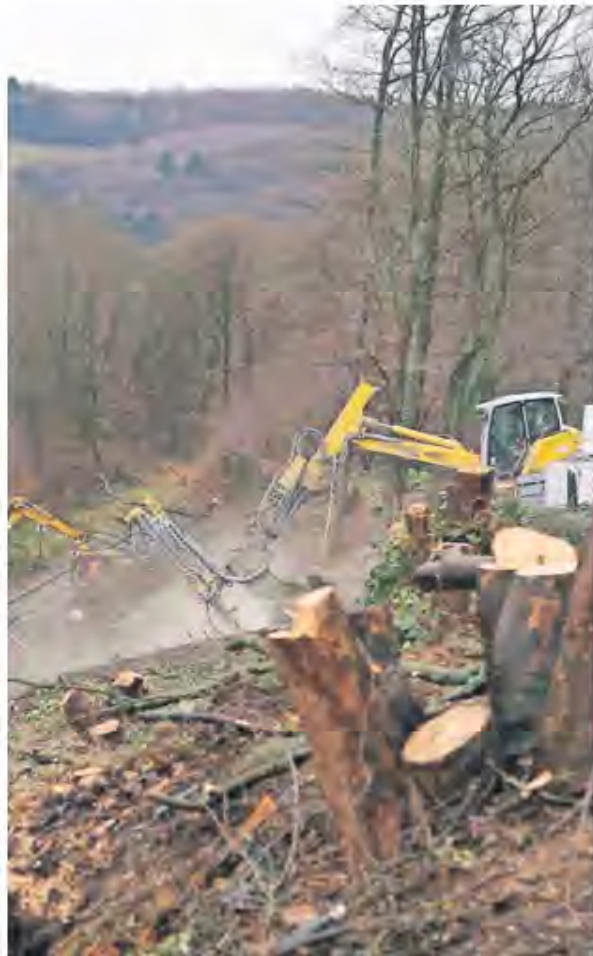
Auf dem Hang an der S7-Strecke versenkt ein Spezialbagger einen von bis zu 600 Anker. Wegen Probleme bei der Verankerung und weiteren Sicherungsarbeiten bleibt die Strecke voraussichtlich zwei Wochen länger gesperrt.
